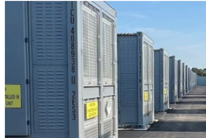
Callisto I 200 MW, 400 MWh
